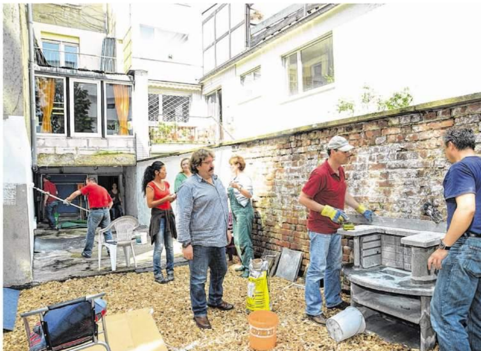
Mitarbeiter der Firma Abiomed legen kräftig Hand an im Außenbereich der Jugend-Tageseinrichtung „Jump“ an der Augustastraße. Dank ihres Engagements können sich die Kinder und Jugendlichen über neue Aufenthaltsmöglichkeiten freuen. Foto: Andreas Herrmann
